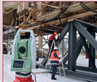
Рис. 7 Контроль деформаций повреждённой конструкции
