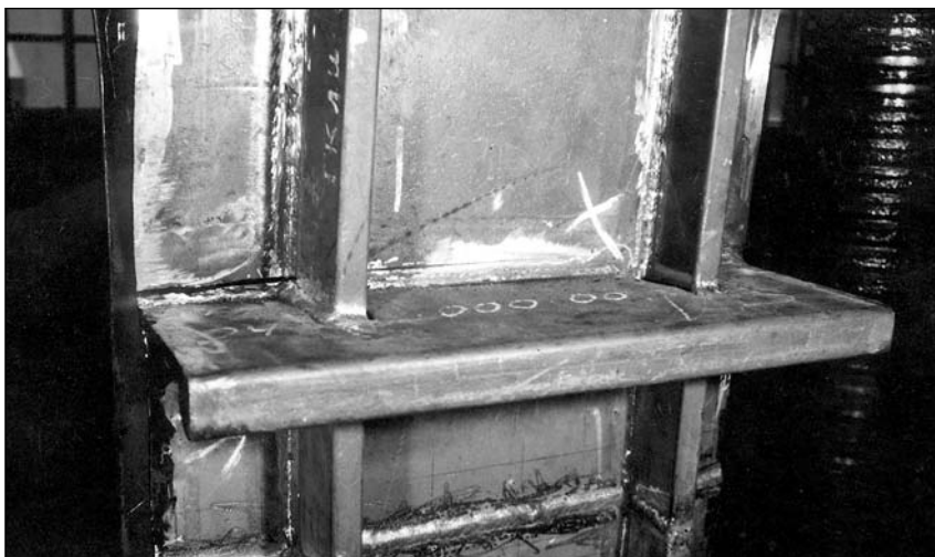
Рис. 4. Трещина в сварном соединении перекрестной связи с обшивкой при наличии внутреннего дефекта шва, появившаяся при испытаниях на циклическую прочность
