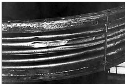
Рис. 3. Вмятины на гофрах сильфонного компенсатора D_y 1600 газовыхлопного тракта маршевых двигателей главной газотурбинной установки большого противолодочного корабля пр. 1155 типа «Удалой»
